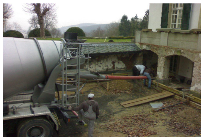
Der Nordflügel drohte abzusinken und musste stabilisiert werden
